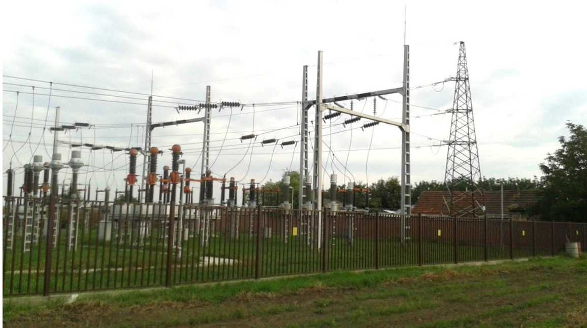
Слика V- НВ 2.1 Изглед трансформаторске станице и надземног вода
