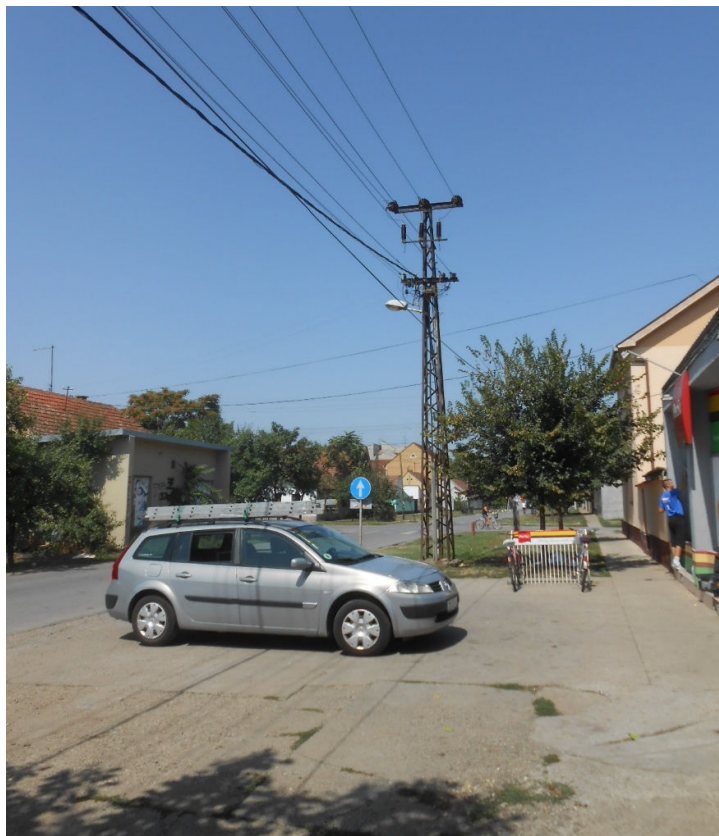
Слика V- НВ 2.1 Изглед надземног вода
