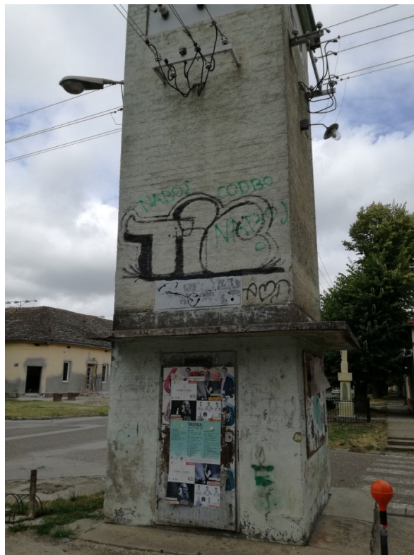
Слика V- ТС 2.1 Изглед трансформаторске станице
