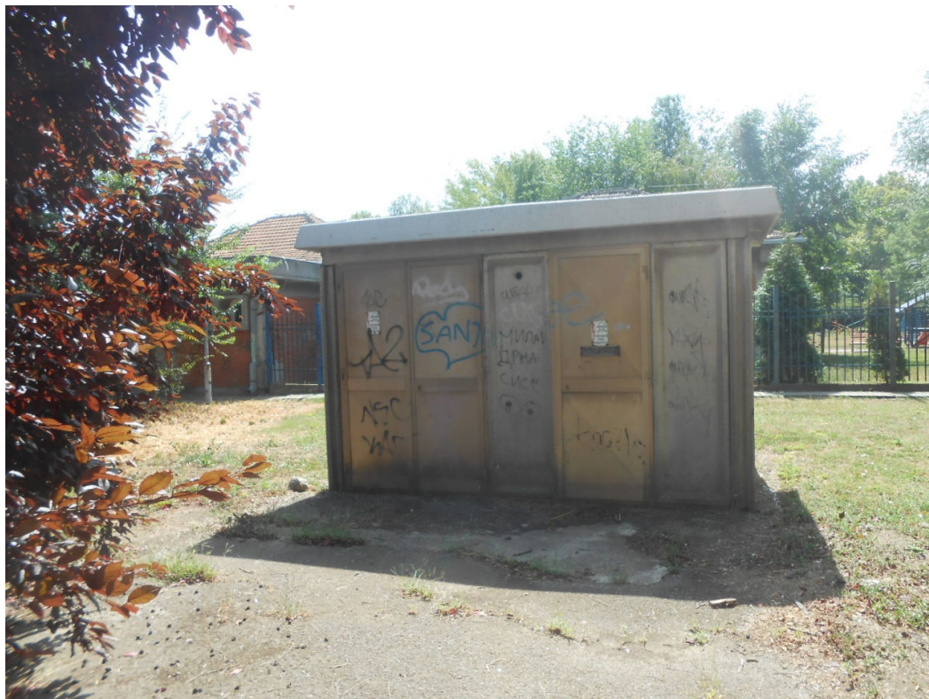
Слика V- ТС 2.1 Изглед трансформаторске станице
