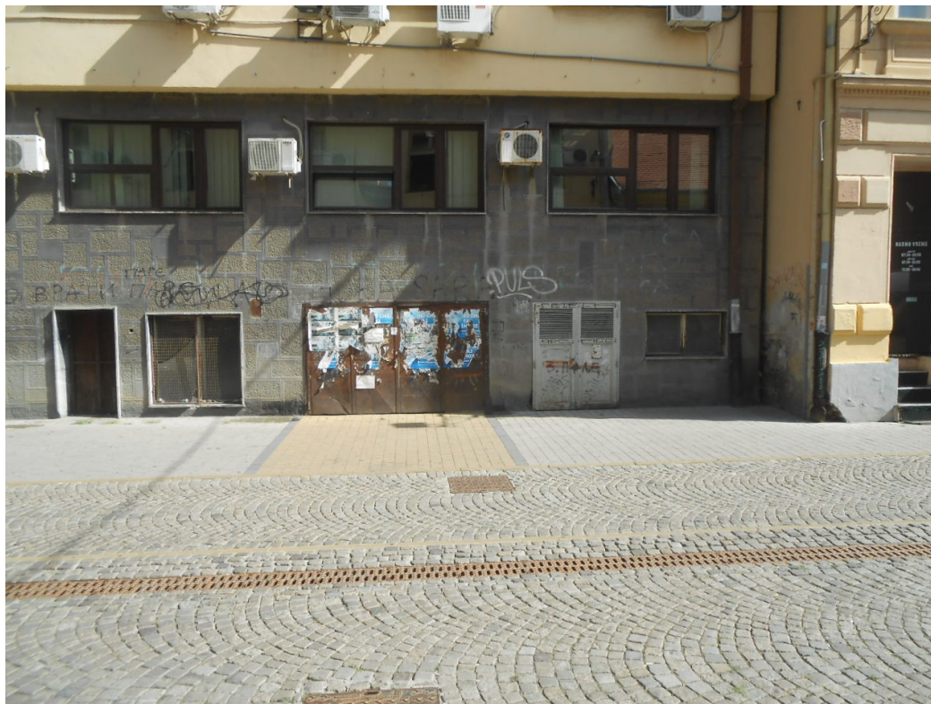
Слика V- ТС 2.1 Изглед трансформаторске станице
