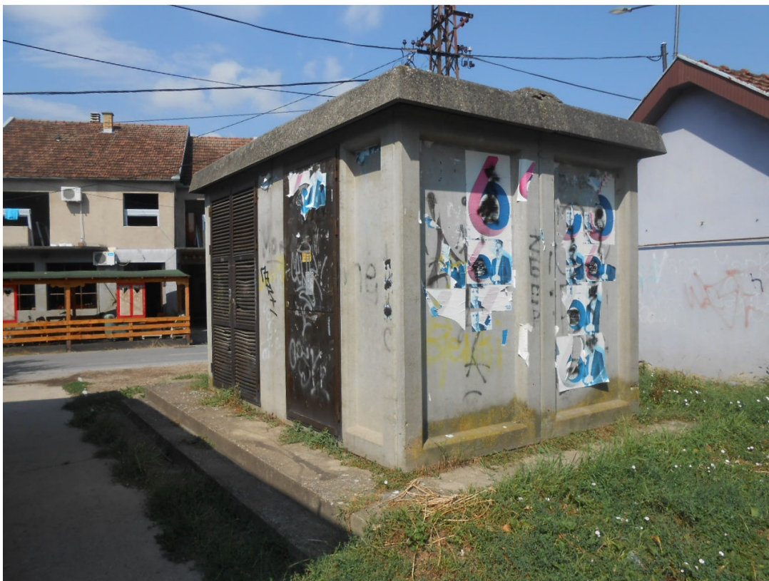
Слика В- ТС2.1 Изглед трансформаторске станице
