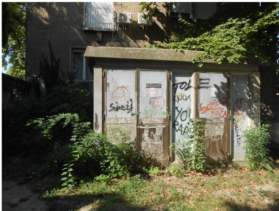
Слика V- ТС 2.1 Изглед трансформаторске станице
