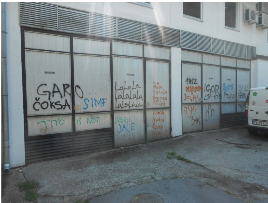
Слика V- ТС 2.1 Изглед трансформаторске станице
