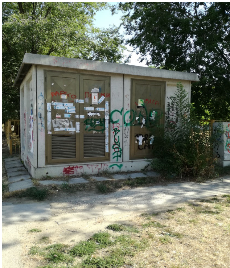
Слика V- ТС 2.1 Изглед трансформаторске станице
