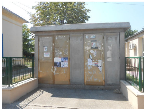
Слика V- ТС 2.1 Изглед трансформаторске станице
