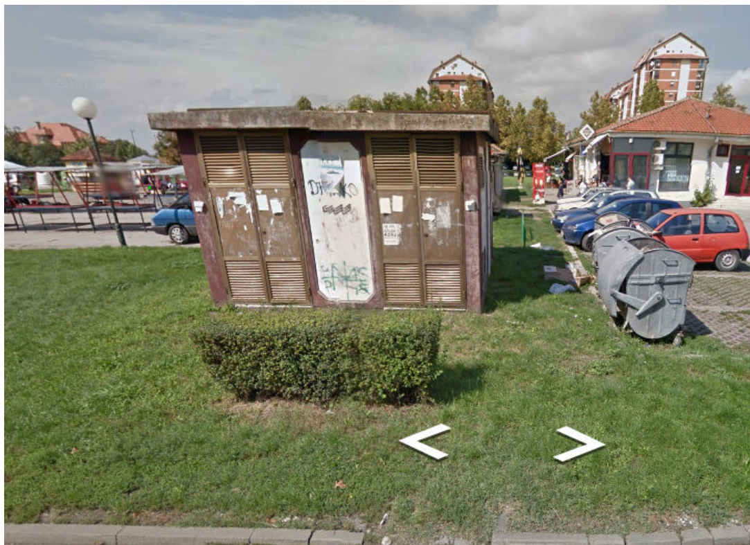
Слика V- ТС 2.1 Изглед трансформаторске станице
