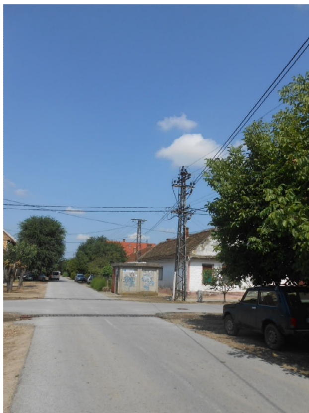
Слика V- НВ 2.1 Изглед надземног вода
