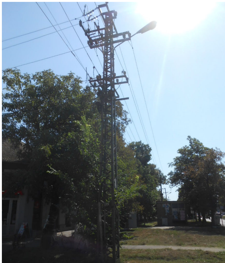
Слика V- НВ 2.1 Изглед надземног вода
