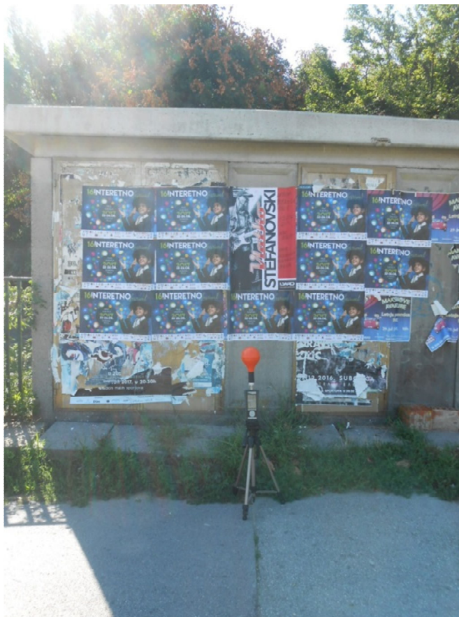
Слика V- ТС 2.1 Изглед трансформаторске станице
