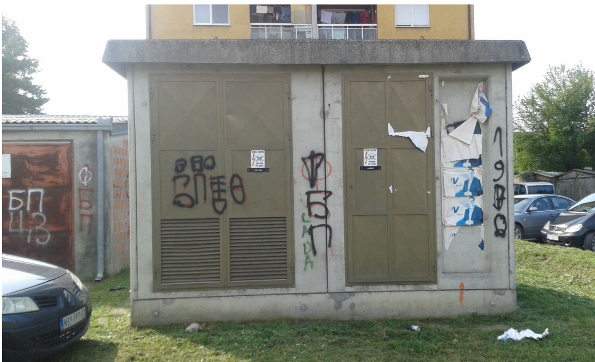
Слика V- TS2.1 Изглед трансформаторске станице
