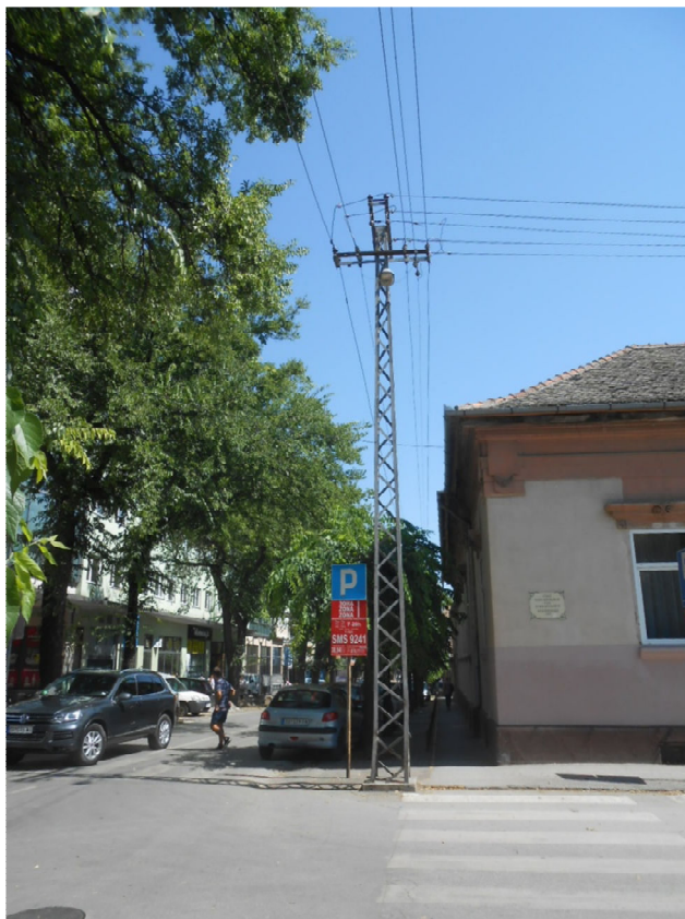
Слика V- НВ 2.1 Изглед надземног вода
