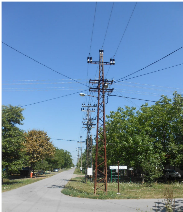
Слика V- НВ 2.1 Изглед трансформаторске станице и надземног вода
