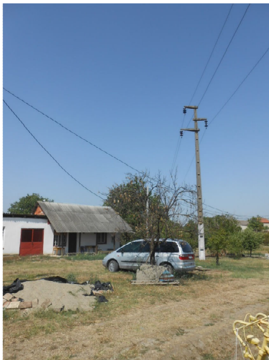
Слика V- НВ 2.1 Изглед надземног вода
