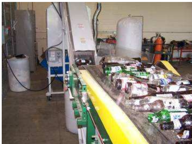
Слика 4.7: Постројење за рециклажу стакла
