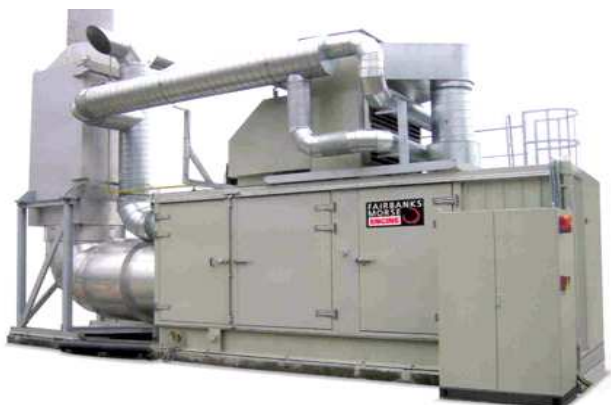
Слика 4.21: Изглед постројења за комбиновану производњу електричне и топлотне енергије
