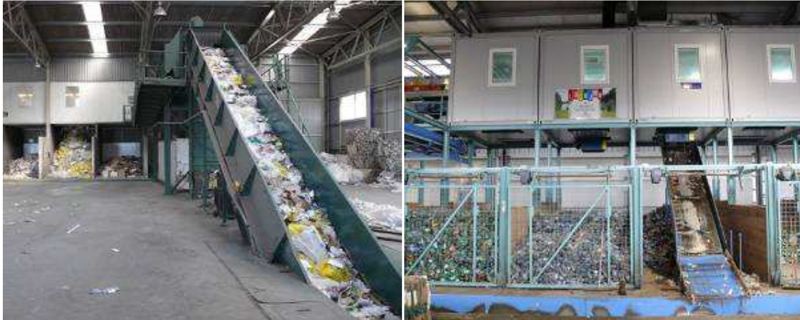
Слика 4.2: Изглед постројења за сепарацију отпада
