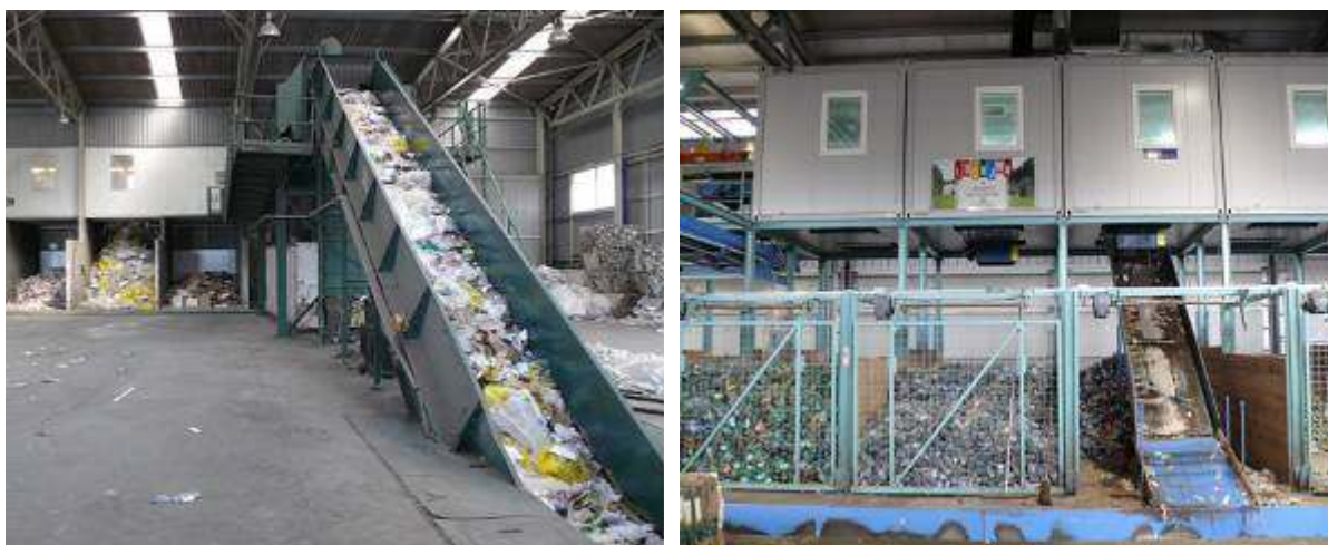
Slika 6.2 Izgled postrojenja za separaciju otpada
