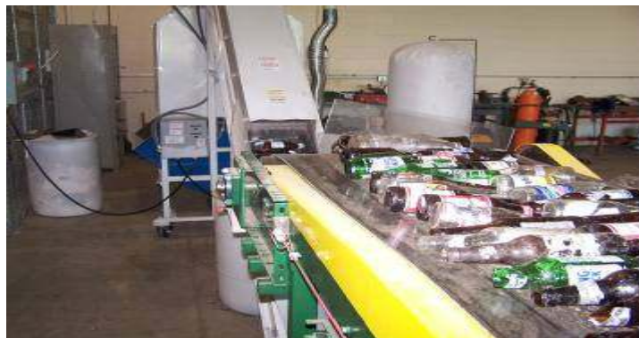
Slika 6.7 Postrojenje za reciklažu stakla
