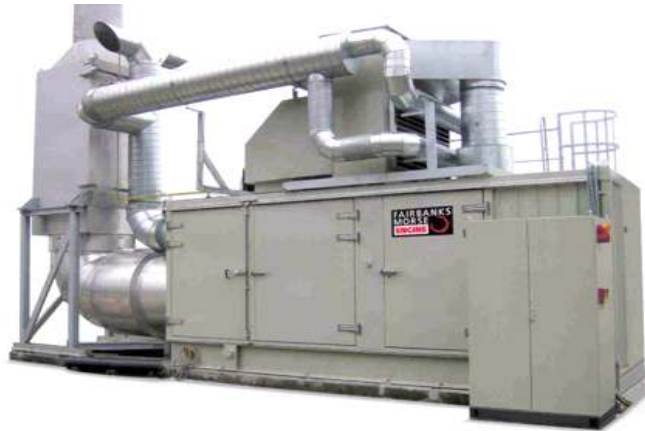
Slika 6.22 Izgled postrojenja za kombinovanu proizvodnju električne i toplotne energije
