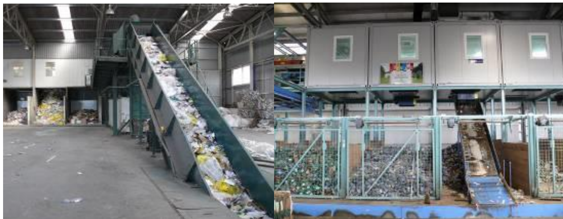
Slika 4 Izgled postrojenja za separaciju otpada
